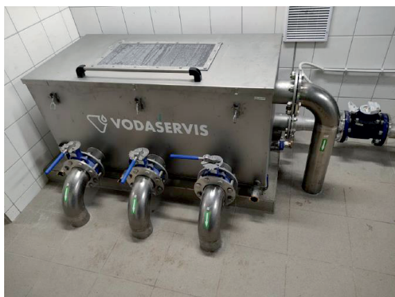
Obrázek 8 Rozdělovací nádrž s odtoky do akumulací
