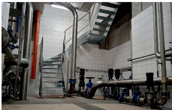
Obrázek 9 Armaturní část úpravy vody
